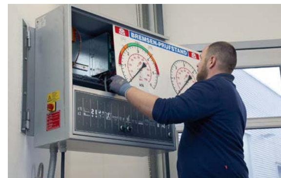
Ran an die Anschlüsse: Die Anzeigentafel eines Rollenbremsprüfstands wird geöffnet.
