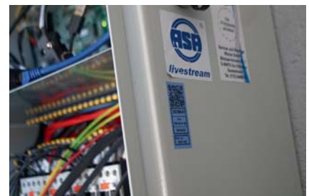
Am Schaltkasten befindet sich die Asanet-work-Livestream-Schnittstelle.
