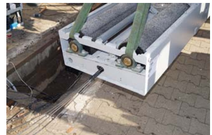
Die Verkabelung des Bremsprüfstands muss noch vor dem Einbau angeschlossen sein.
